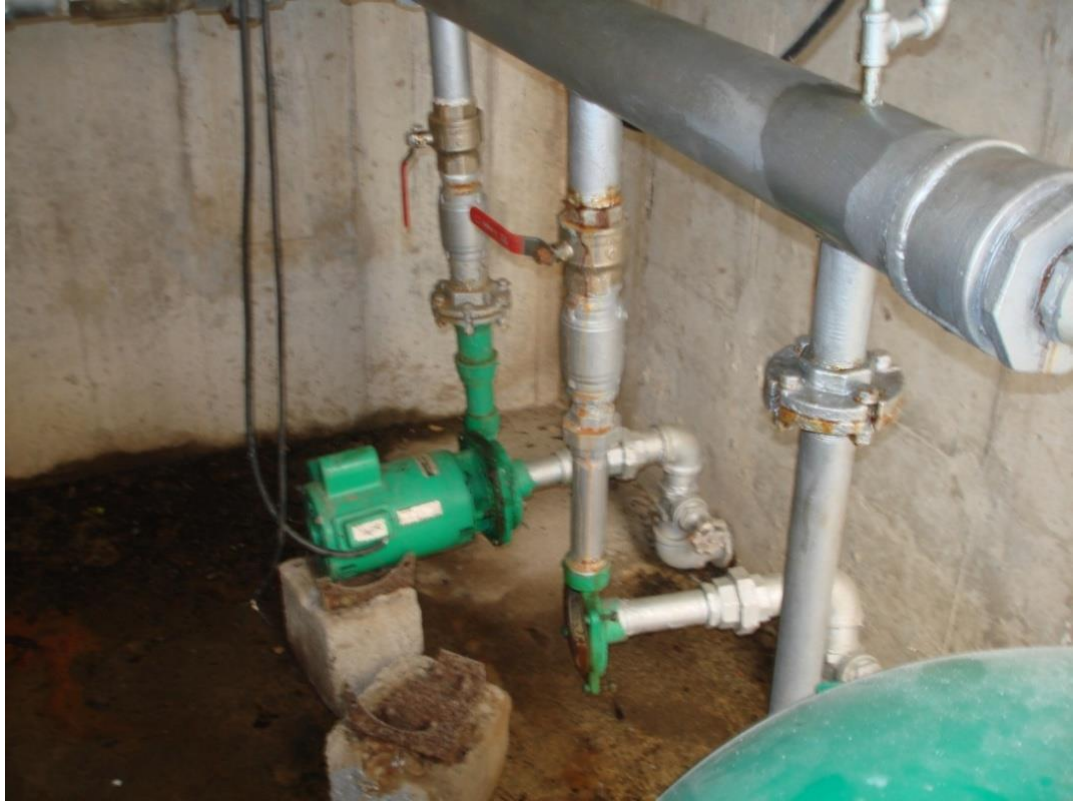
Figura 19. Ubicación de Motobombas
