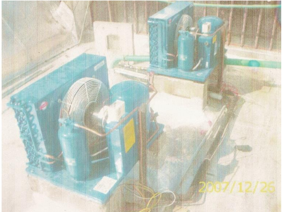
Figura 23. Unidades de enfriamiento
