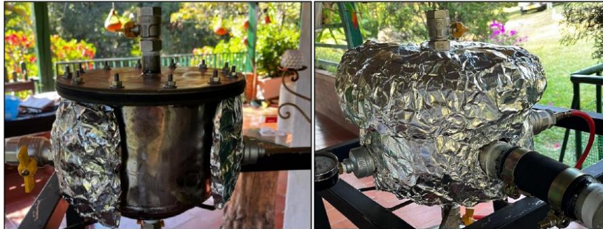
Figura 6. Tanque de condensación con las piezas de aislamiento térmico
