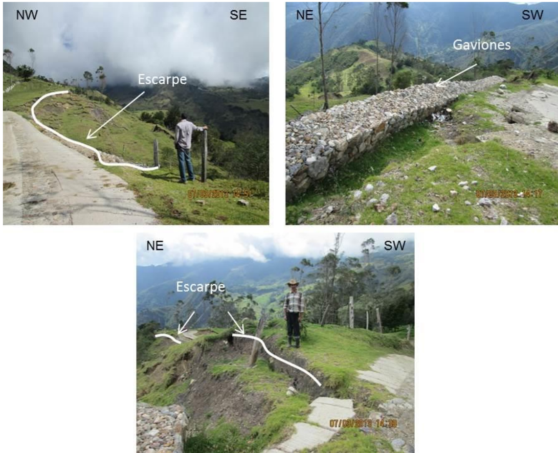
Figura 74. Deslizamiento rotacional con amplia afectación en la finca Yotuel y la carretera que comunica al municipio de Tona con el corregimiento de Berlín.
