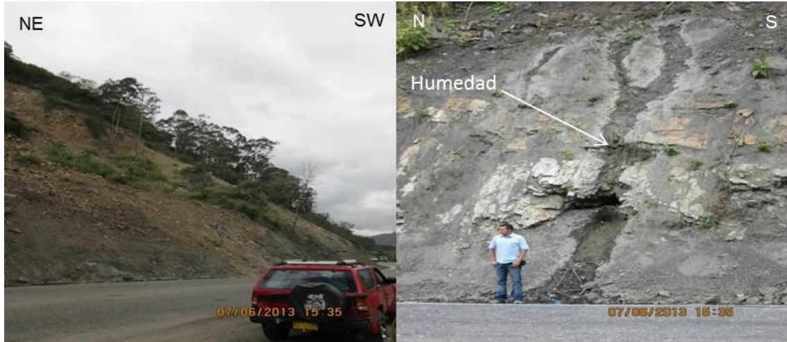
Figura 77. Movimiento compuesto, deslizamiento traslacional con caída de roca; se observa los problemas de humedad, ubicado en el corredor vial que comunica al municipio de Pamplonita con el municipio de Cúcuta.
