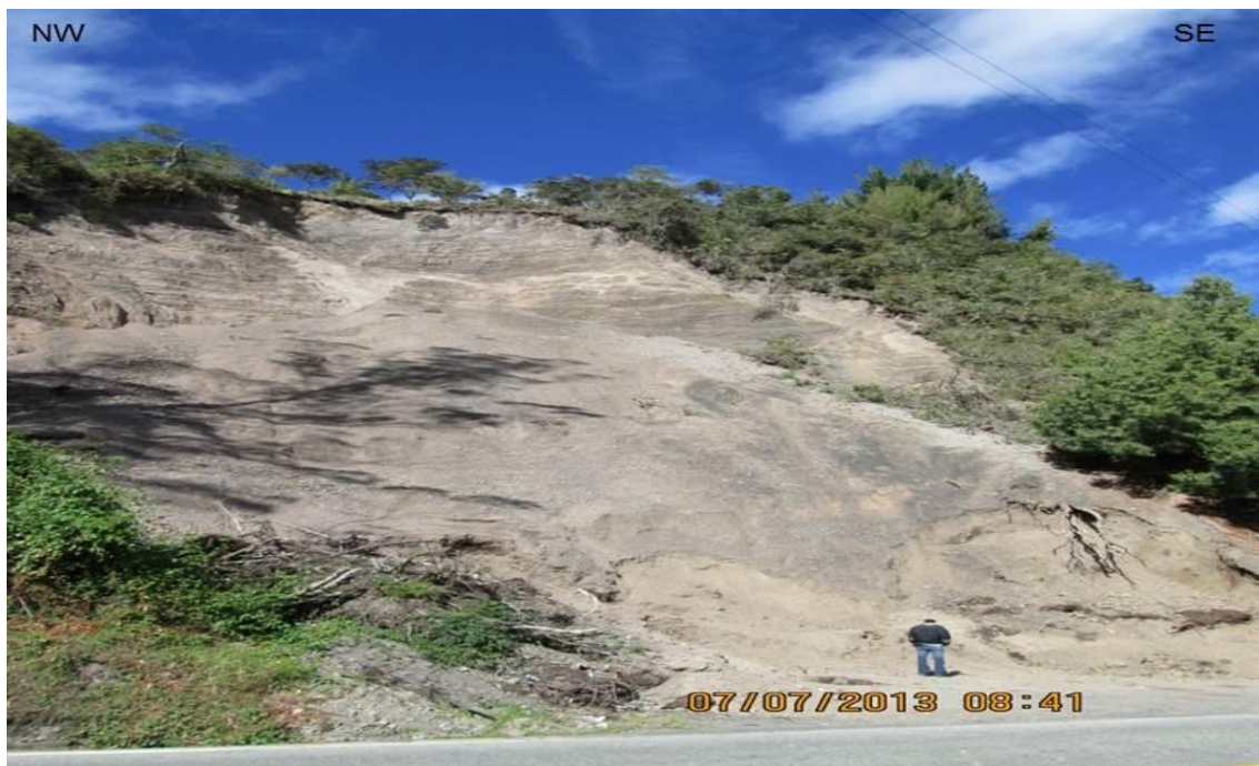
Figura 76. Deslizamiento traslacional planar, antigua cantera de extracción de material para relleno, municipio de Mutiscua, departamento de Norte de Santander.
