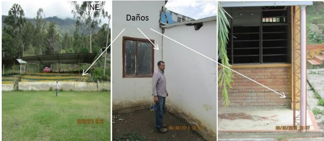
Figura 66. Deslizamiento rotacional sobre el Casco Urbano del municipio de Surata, departamento de Santander. Se observa el gran impacto que ha tenido sobre la infraestructura presente en la zona.
