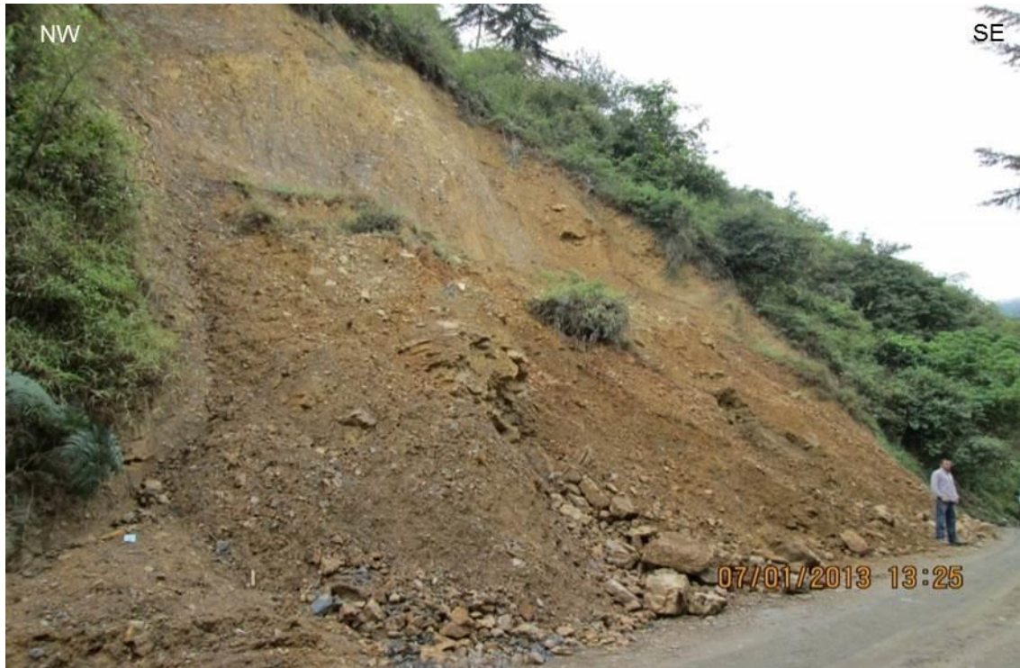
Figura 71. Movimiento complejo, deslizamiento traslacional planar con caída de roca. Afectación de la carretera que comunica al municipio de California con el municipio de Surata.
