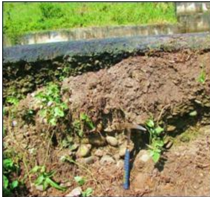
Figura 11. PR 89+500. Pérdida de suelos de la estructura de la vía por lavado y presencia de clasto soportado.
