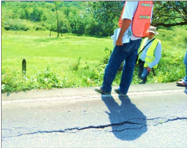
Figura 10. PR 89+500. Agrietamientos en el borde externo de la calzada.
