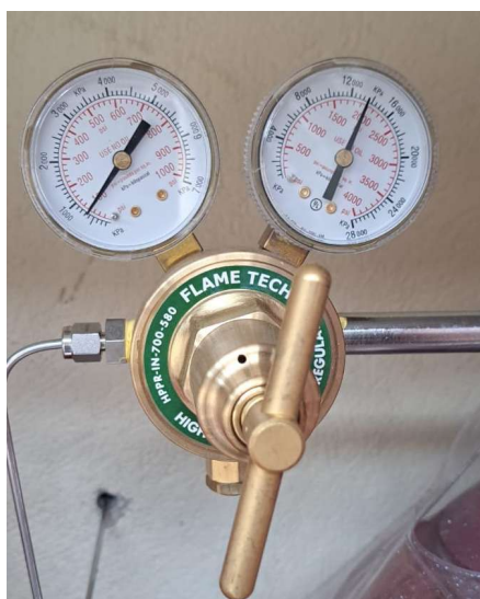
Figura 8. Reguladores de presión instalados en los cilindros con gases de puros
