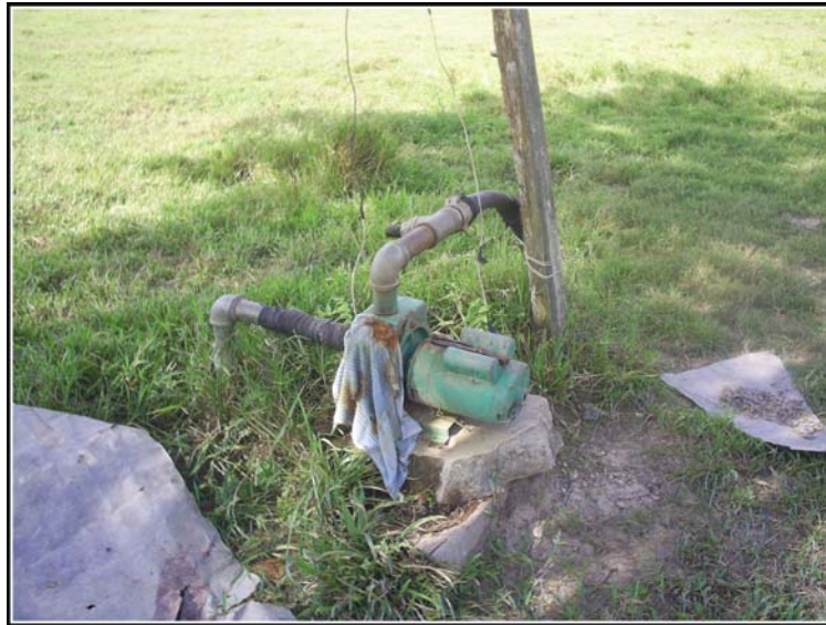
Bomba de extracción de 2 HP
