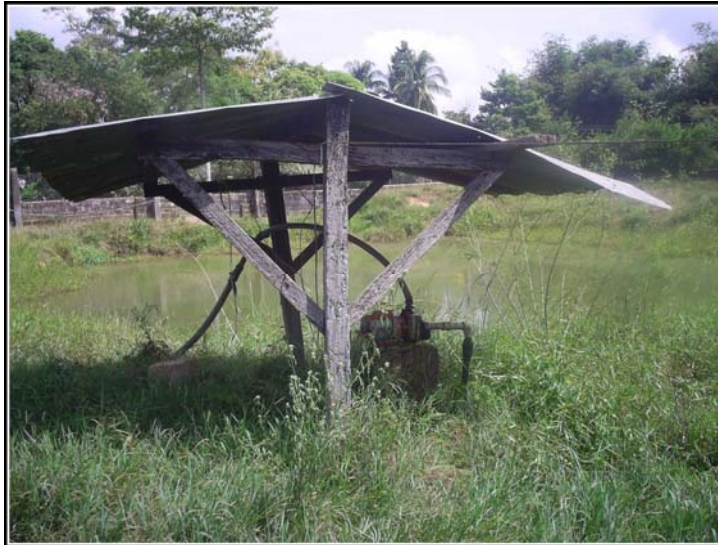
Pozo cisterna de 18 m de profundidad y bomba de extracción de 2 HP
