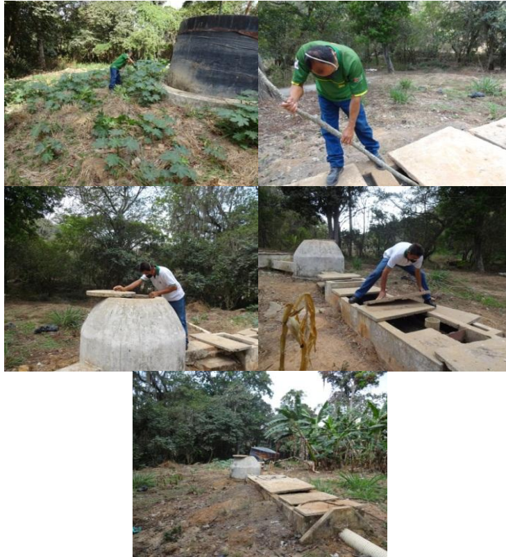
Figura 7. La Planta de Tratamiento de Aguas Residuales
