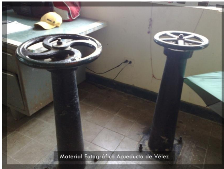
Foto 7: Válvulas, para el lavado de los filtros.
