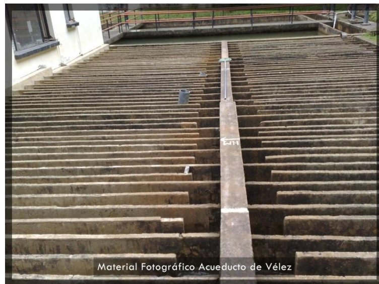
Foto 3: Canaletas donde se da el proceso de floculación.
