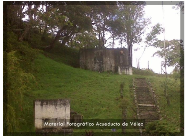
Foto 12: Tanque de almacenamiento del acueducto.
