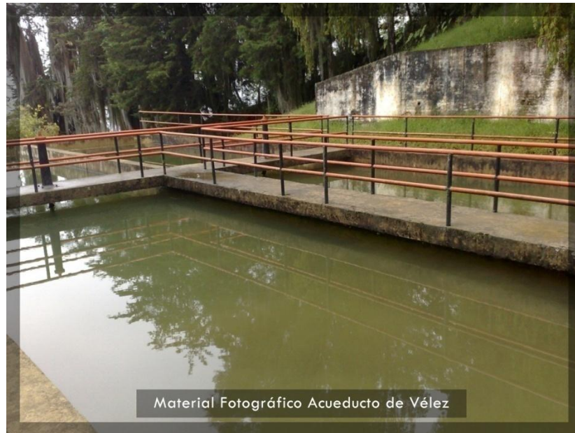
Foto 4: Tanques de clarificación.
