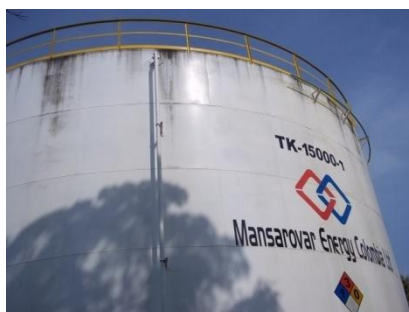
Figura 10. Tanque de almacenamiento de nafta craqueada con techo fijo.
