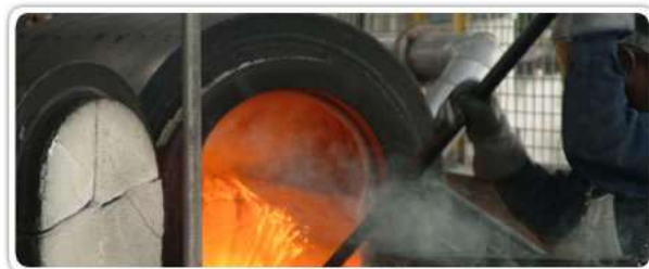
Figura 18. Caldera para la producción de vapor
