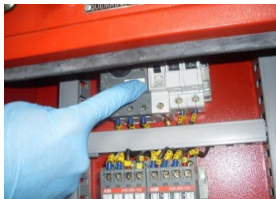
Taco de energía de caldera
