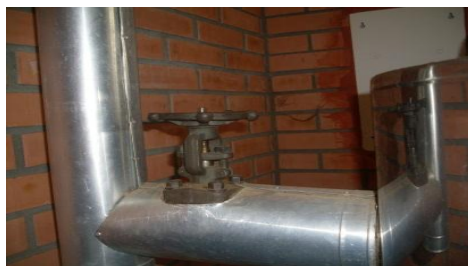
Válvula de vapor principal cerrada
