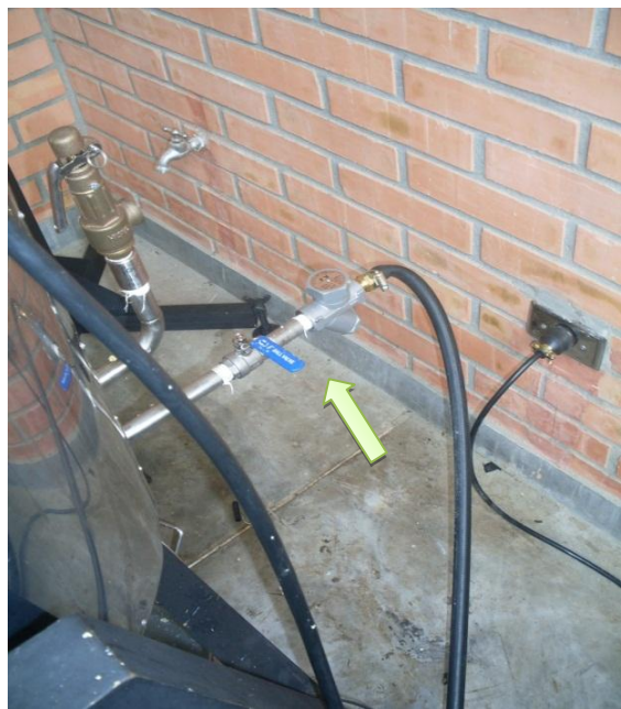
Foto 4: Válvula condensados y valvula
