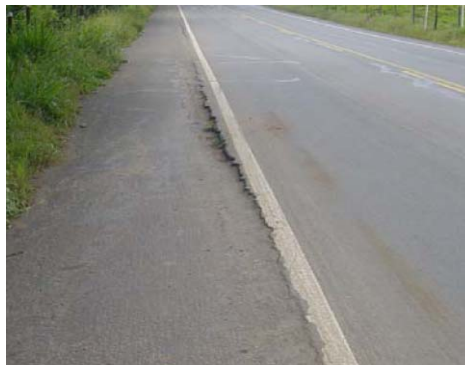
Figura 91. Corrimiento de la berma.
