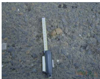
Figura 83. Desprendimiento tipo cabeza dura.
