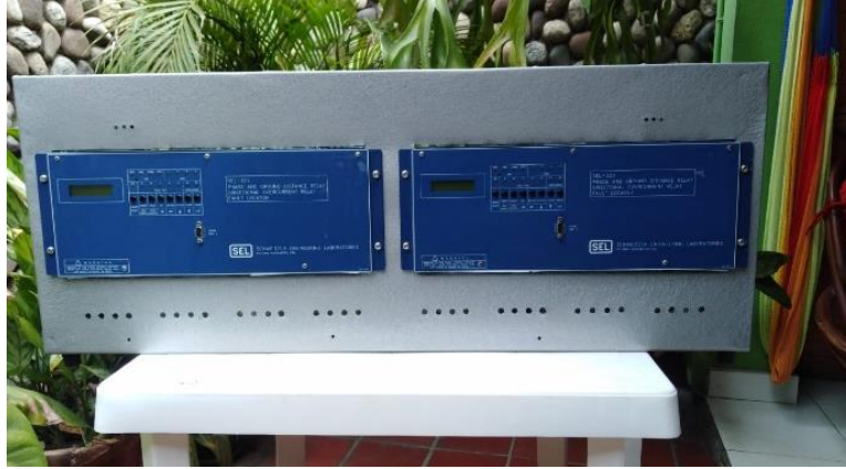
Relés Instalados en el Gabinete
