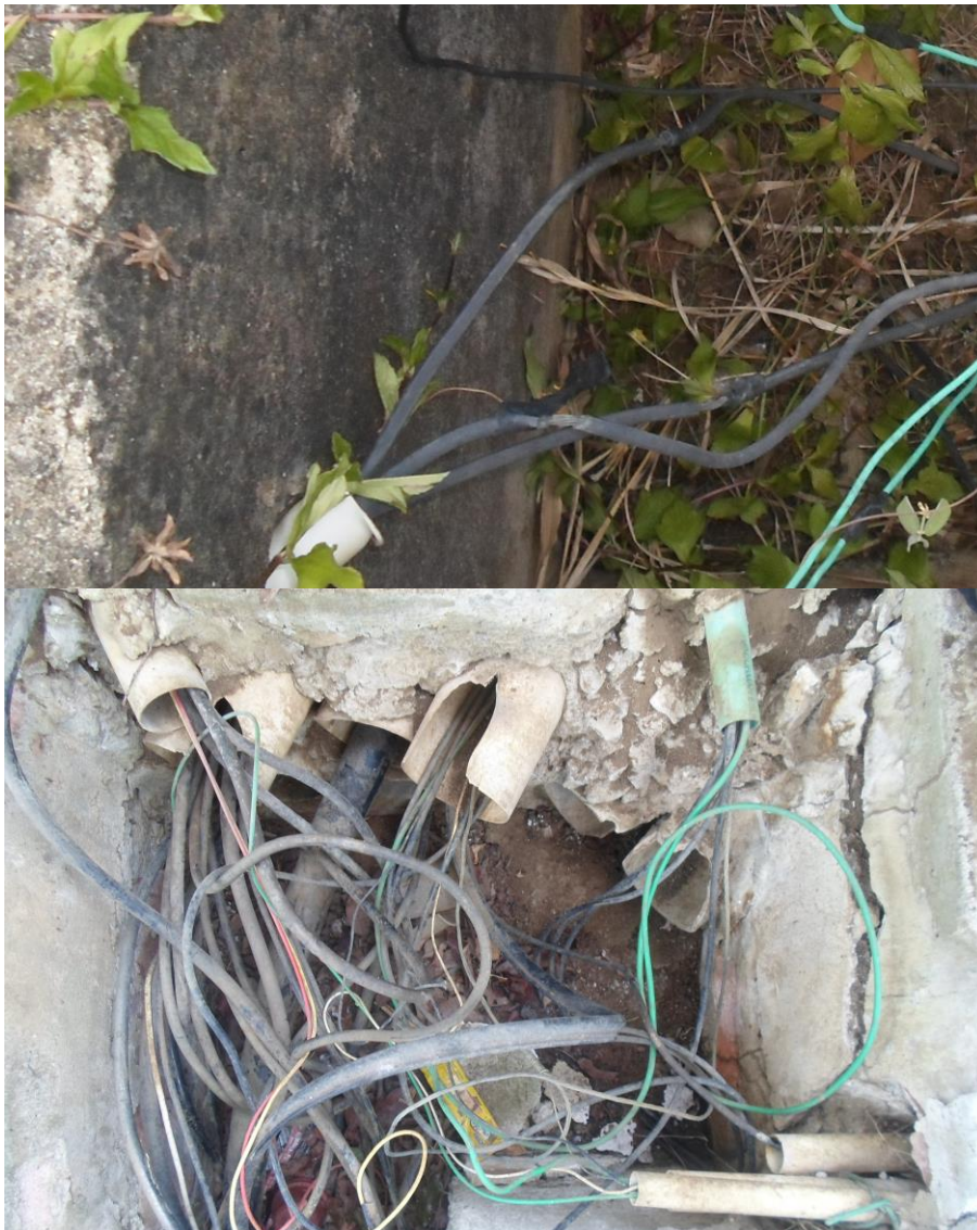
Figura 8 Cableado de la red existente de alumbrado público.
