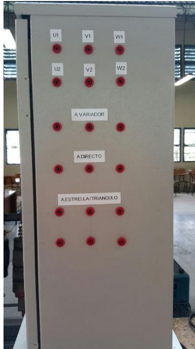
Figura 33 Parte Lateral derecha del tablero
