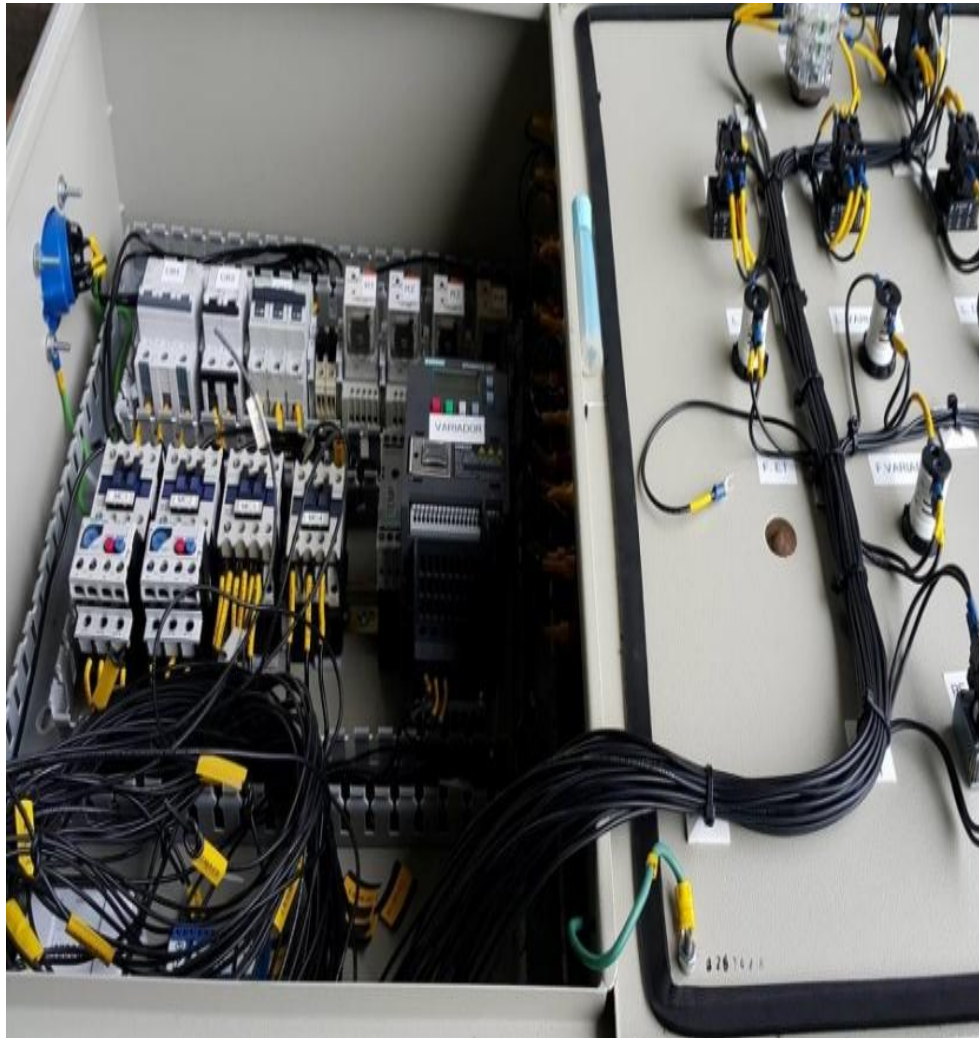
Figura 35 Cableado del cofre
