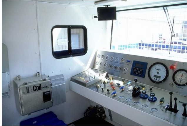
Figura 36. Fotografía de una consola de control
