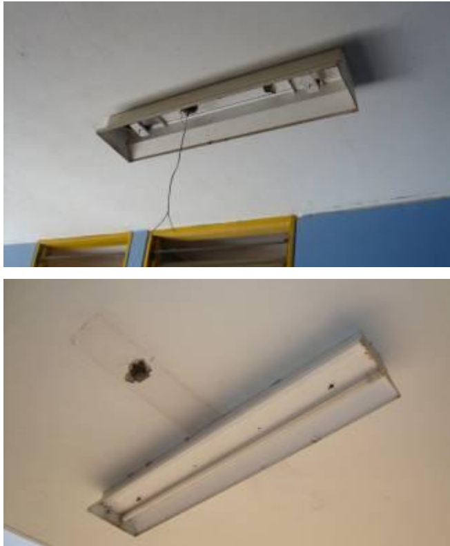
Figura 27. Lámparas existentes en mal estado
