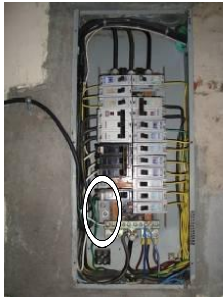
Figura 12. Riesgo por sobrecarga, Tablero TD1 Instituto de Lenguas
