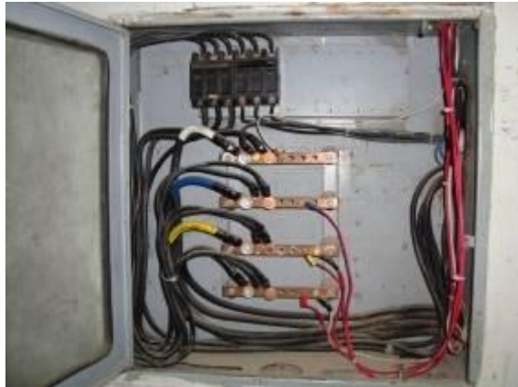
Figura 7. Riesgo por arco eléctrico, contacto directo e indirecto, en el cuarto de barraje del Instituto de Lenguas
