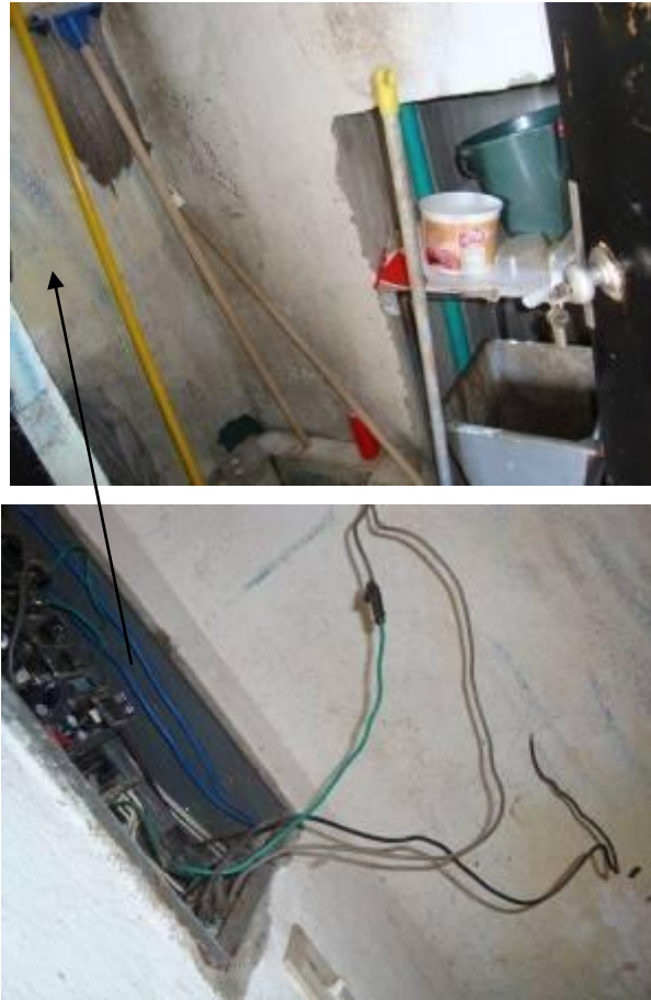
Figura 13. Riesgo de arco eléctrico, localidad 205 Federico Mamitza Bayer
