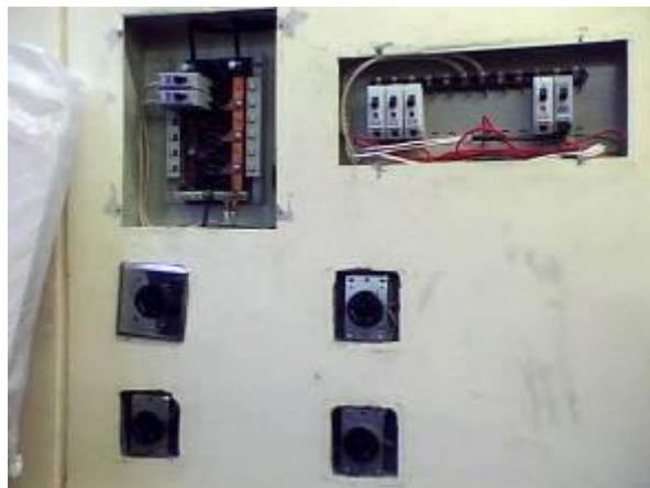
Figura 17. Instalación defectuosa, riesgo de tensión de contacto, módulo de regulación salón 109, Federico Mamitza Bayer
