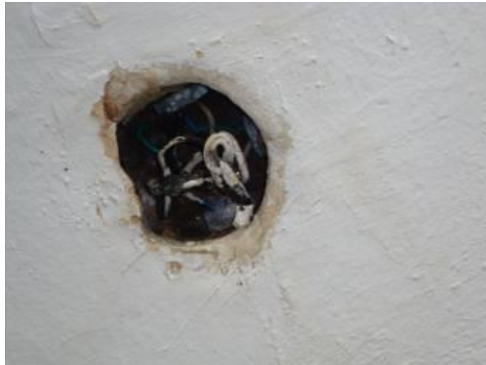
Figura 15. Riesgo por conexiones anormales, corrosión, Federico Mamitza Bayer hall tercer piso
