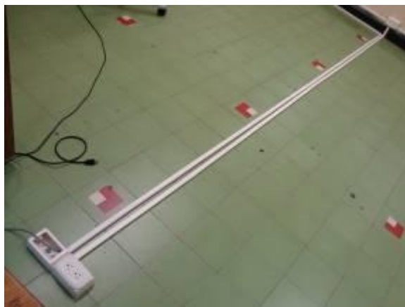
Figura 9. Riesgo por contacto directo e indirecto, tomacorriente en el piso sin ninguna protección de falla a tierra, Instituto de lenguas
