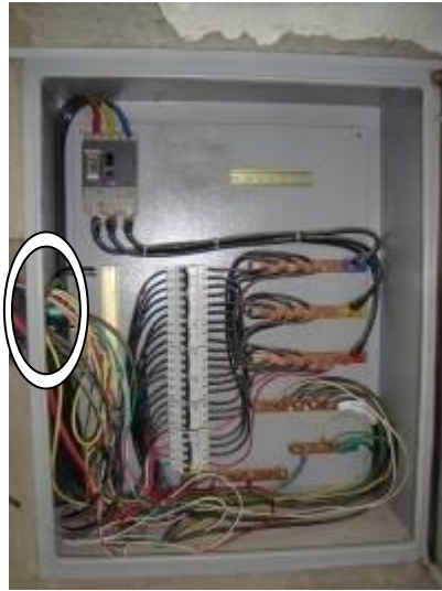
Figura 8. Canalización saturada, cuarto barraje Instituto de lenguas.
