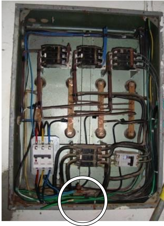
Figura 18. Riesgo de falla a tierra, debido a la exposición de conductor de fase, TGBT1 Federico Mamitza Bayer.
