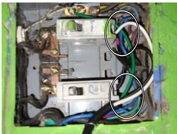
Figura 20. Riesgo de sobre carga, debido al no proteger el circuito ramal de un elemento de alto consumo de potencia, Federico Mamitza Bayer
