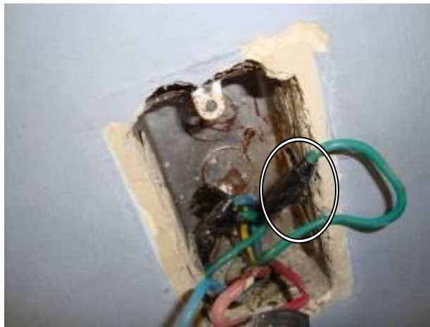
Figura 16. Riesgo de cortocircuito, por exposición de conductor de fase, interruptor sala de cómputo, Federico Mamitza Bayer.
