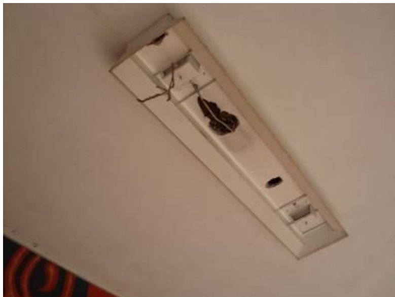
Figura 19. Riesgo de contacto indirecto, debido al roce del conductor de fase con la carcasa de una luminaria, pasillo 1-A Federico Mamitza Bayer
