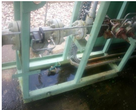
Foto 11 Residuos líquidos de gas condensado
