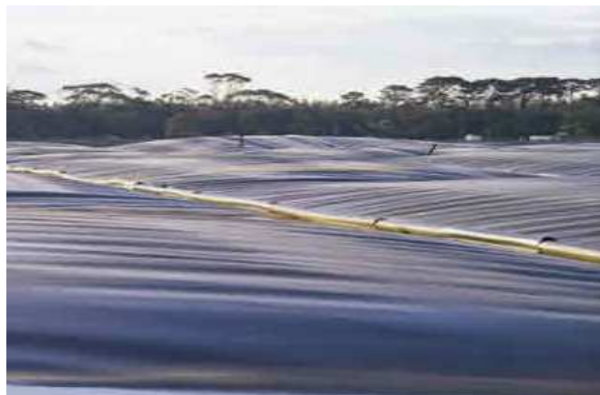
Ilustración 13. Sistema de Geomembrana de recubrimiento
