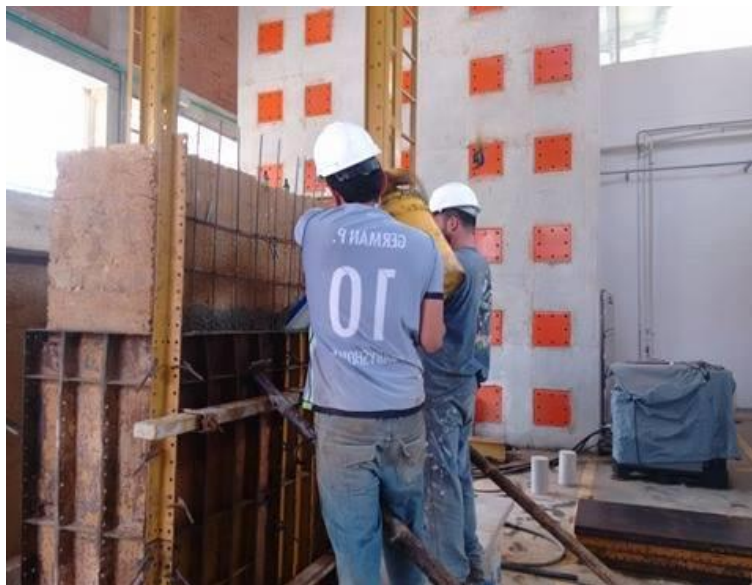
Figura 10. Vertida de concreto
