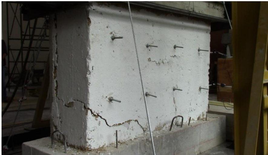
Figura 25. Plano de falla en el muro de tapia pisada reforzado
