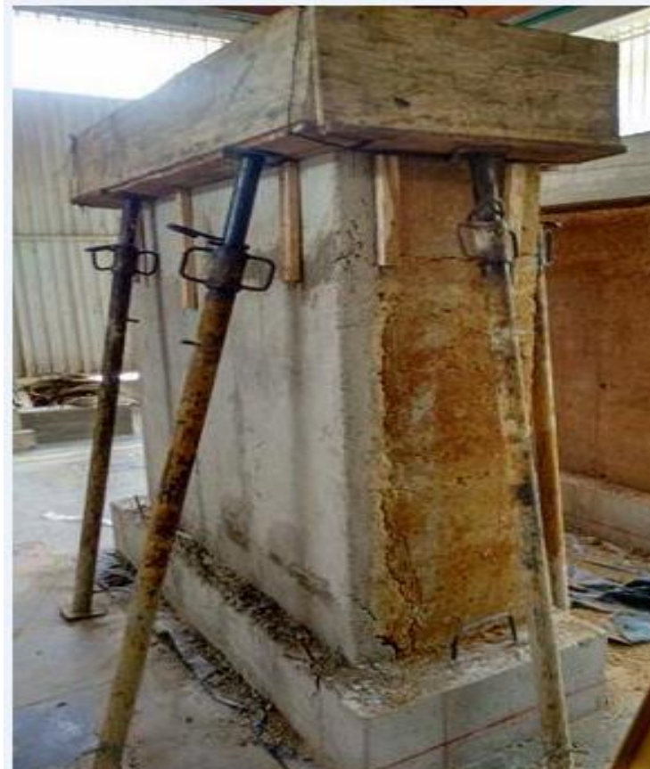
Figura 11. Muro en tapia pisada reforzado con un muro estructural
