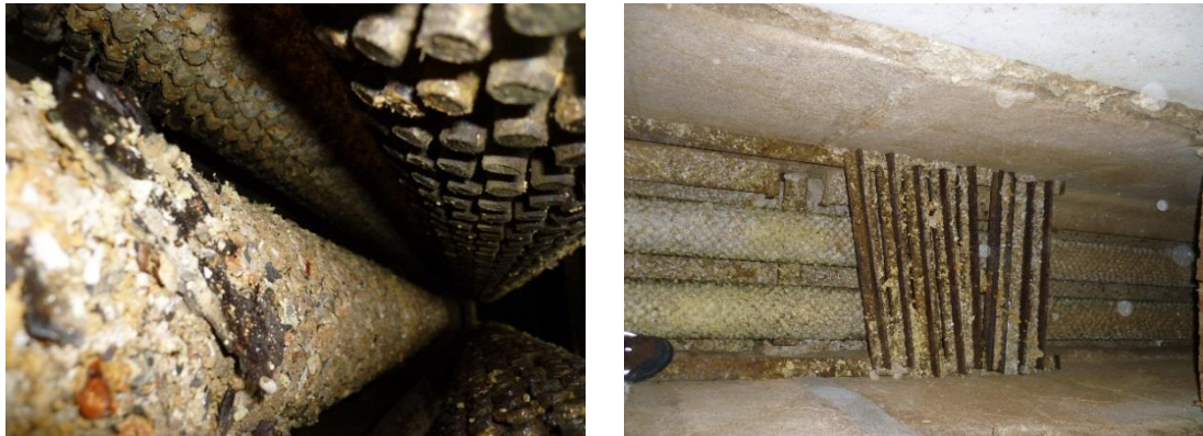
Figura 3. Formación de compuestos de azufre en la superficie del haz de tubos del horno H-201
