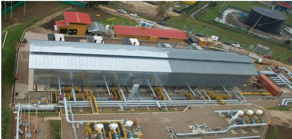
Figura 10. Estación compresora de gas de Miraflores
