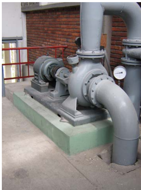
Figura 74. Base del equipo de bombeo del Banco de Turbina Francis.
