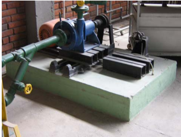
Figura 77. Base del equipo de bombeo del Banco de Turbina Pelton.
