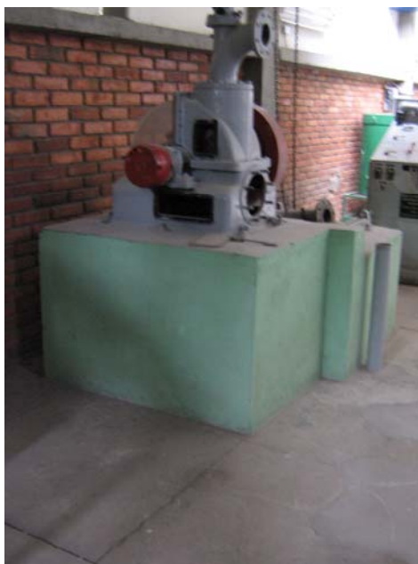
Figura 70. Base y montaje del Banco de Turbina Pelton.
