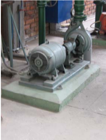
Figura 75. Base del equipo de bombeo del Banco de Turbina Michell Banky.
