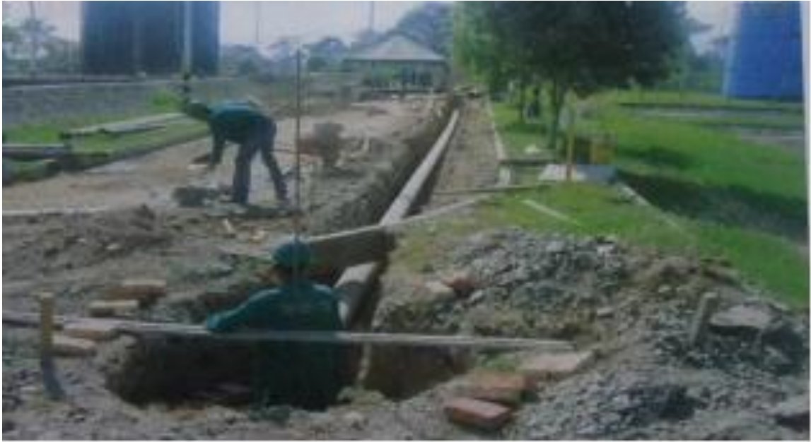
Foto: Reemplazo de tuberías para hacer segregación de aguas aceitosas y aguas lluvias
