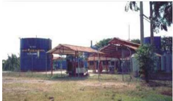
Figura 19 Sistema de almacenamiento Estación 2
