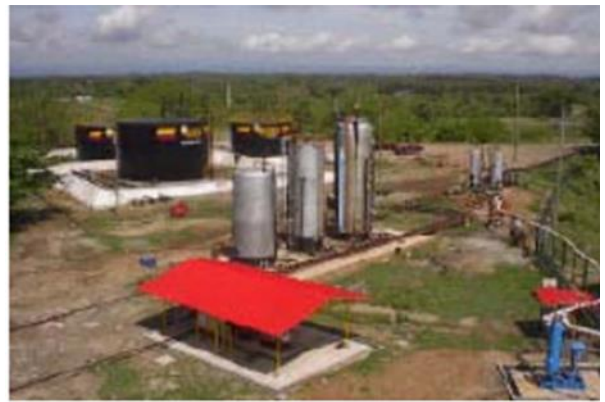
Figura 16 Sistema de Almacenamiento Campo Palagua
