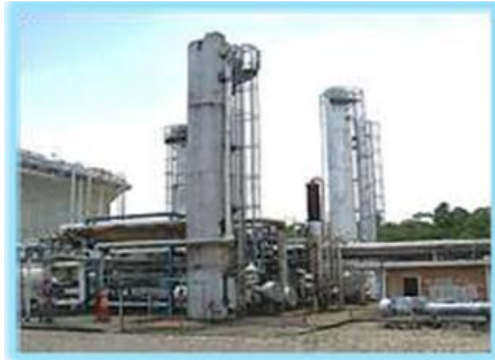
Figura 11. Planta de procesamiento de Gas Payoa
