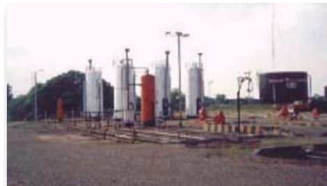
Figura 17 Sistema de Almacenamiento Campo Caipal
