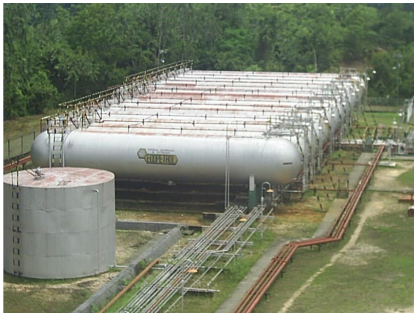
Figura 7. Foto tomada a los tanques de almacenamiento de Blancos
