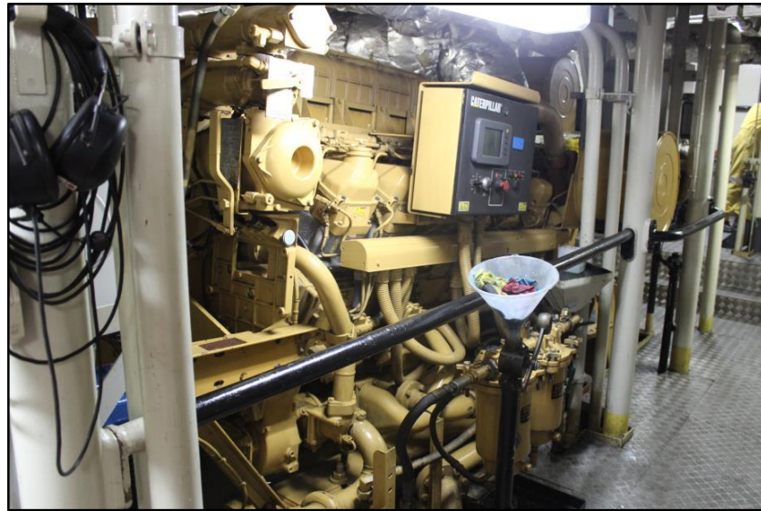
Figura 18. 9004-P-MOT-0101 Motor Propulsor
