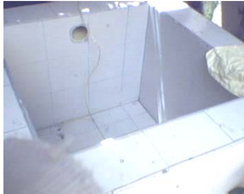
Figura 17. Tanque usado para neutralización de compuestos químicos
