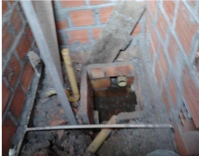
Figura 21. Instalaciones de evacuación de aguas servidas.
