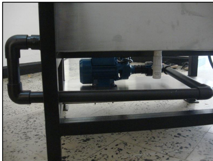
Figura 4. Línea de succión de la bomba de llenado
