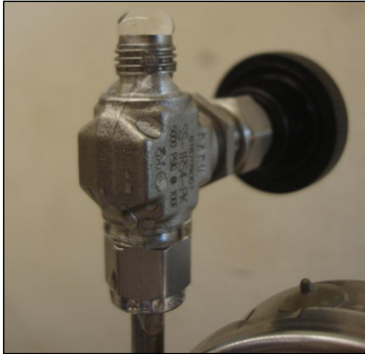
Figura 293. Purgado de la prueba de integridad
