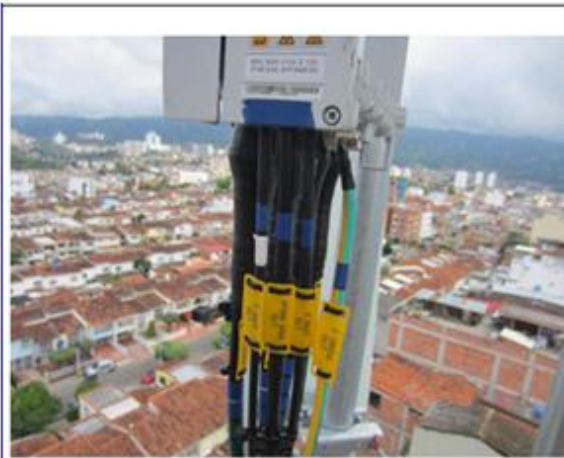
Marquillas JUMPER, FIBRA OPTICA Y CABLE DC Sector 1 (PRIMER PLANO)
