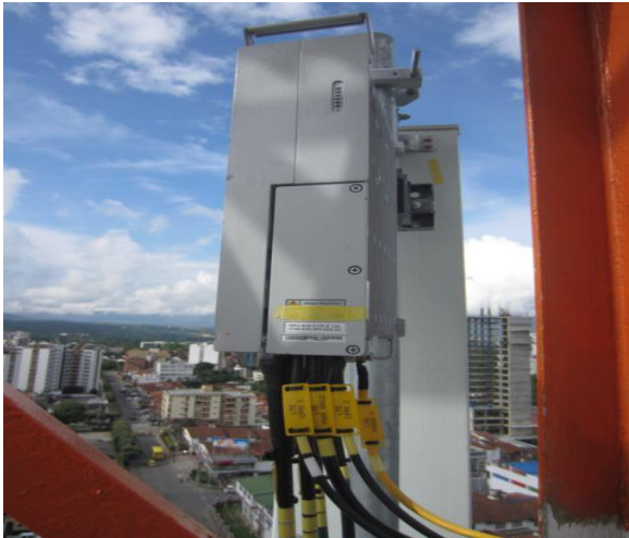
Figura 19. Vista frontal de RRU
