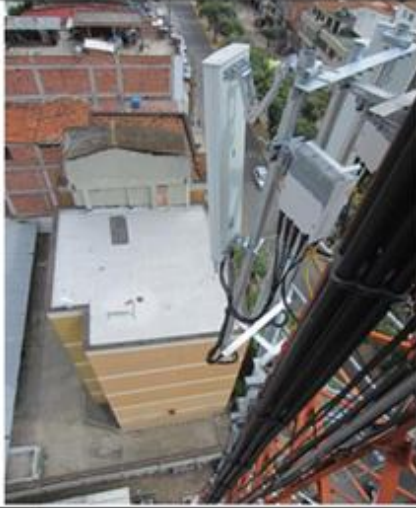
Panorámica RRU Sector1 (Que se vea plataforma y antena)
