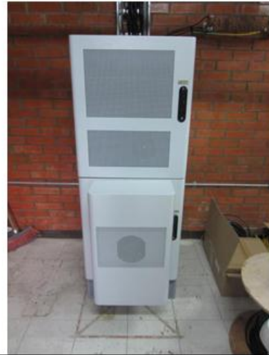
Panorámica superior de distribución final de los equipos
