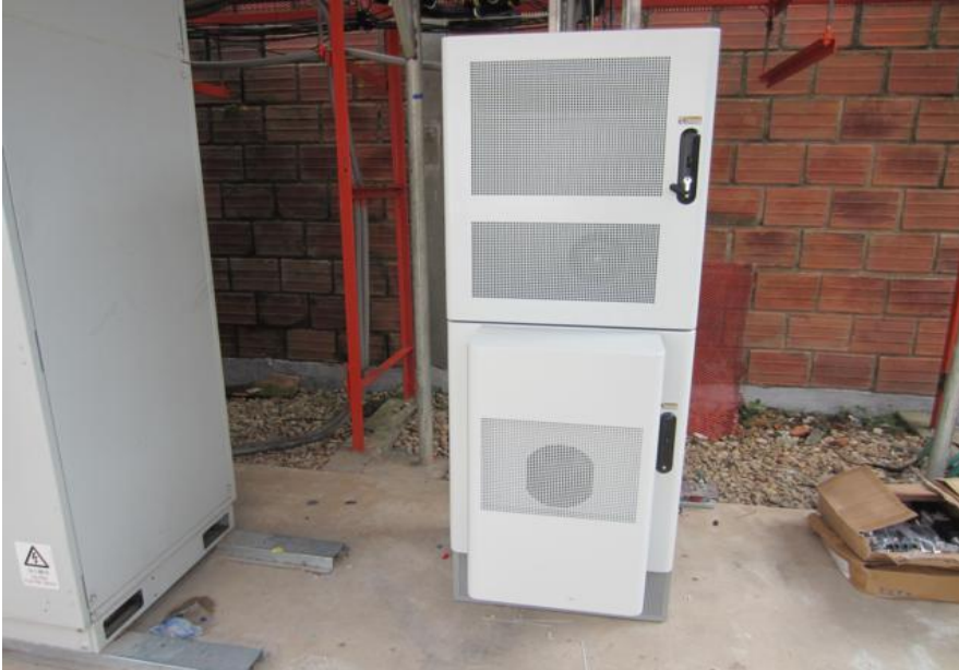
Figura 14. Gabinetes de BBU, rectificador y baterías.
