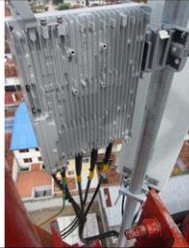
Panorámica RRU Sector1 (Plano Completo RRU con cableado en mastil)
