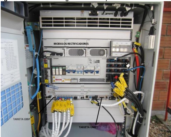
Figura 15. Vista interior del gabinete de BBU y rectificador.
