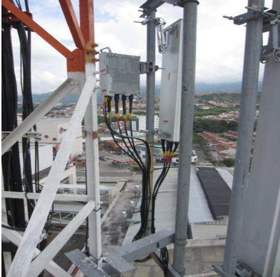
Figura 18. RRU y conexiones hacia antena
