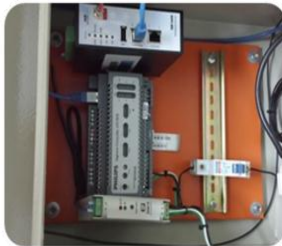
Figura 17. Tablero de control
