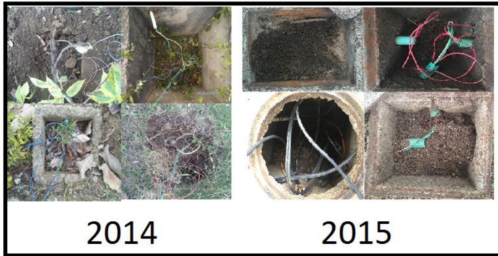
Figura 10 Estado de Cámaras de inspección de la red eléctrica de alumbrado público.
