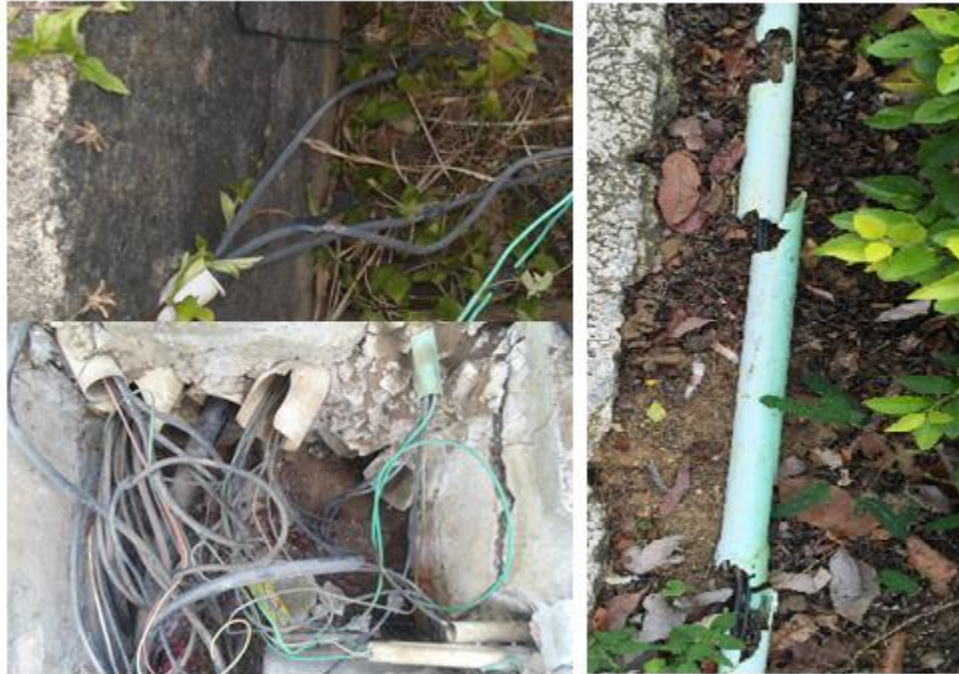
Figura 11 Cableado de la red existente.
