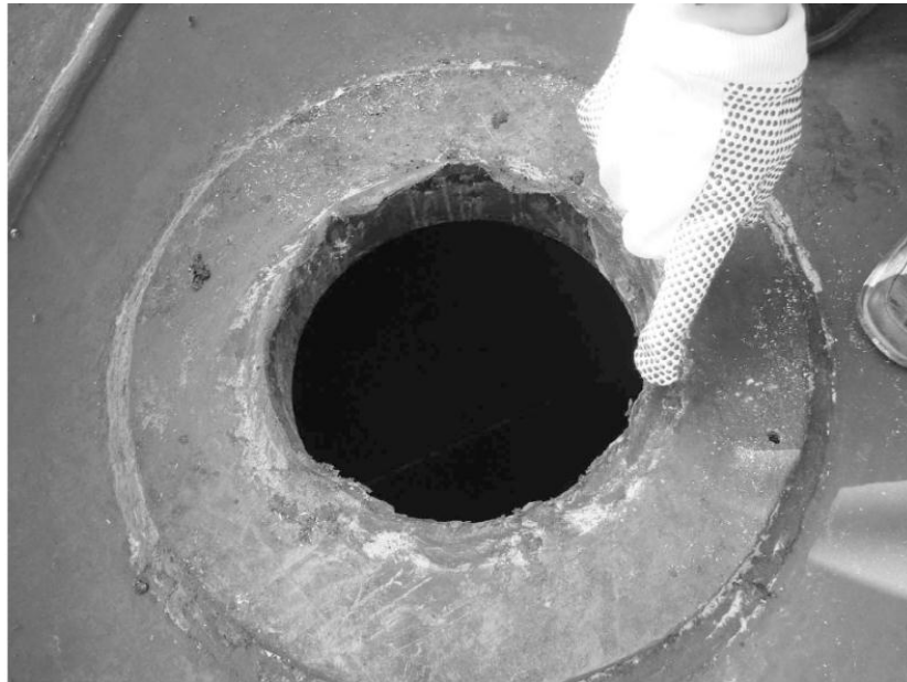
Figura 5. Deterioro de las tuberías por corrosión
