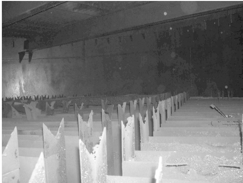
Figura 8. La corrosión del depósito de recogida de aceite en el tercer piso
