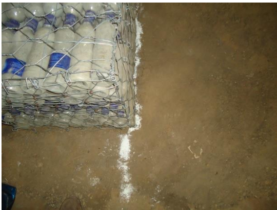
Figura 14. Deslizamiento del gavión con botellas PET
