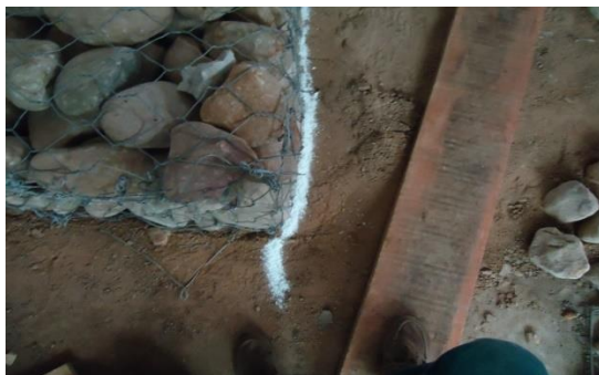
Figura 8. Marca de desplazamiento del gavión tradicional
