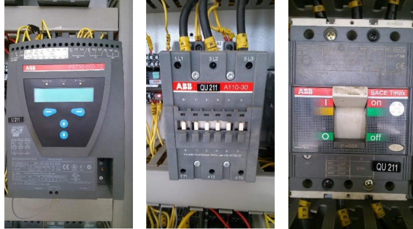
Figura 45. Arrancador suave, contactor y breaker del digestor
