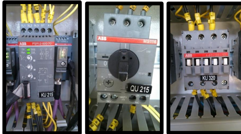
Figura 36. Arrancador suave, guardamotor y contactor para el control eléctrico-electrónico
