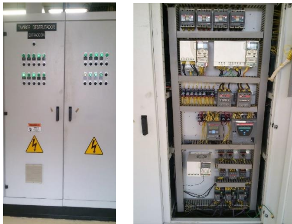
Figura 23. Tablero de control extracción
