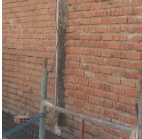
Figura 11. Columnas de construcciones vecinas invadiendo el lote.
