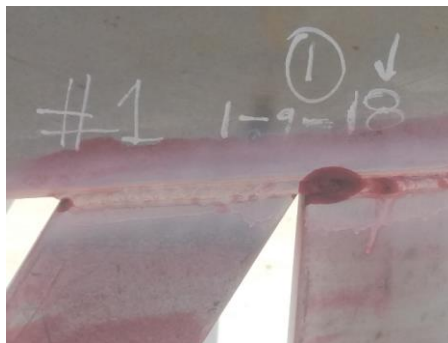
Figura 17. Soldadura con porosidad.
