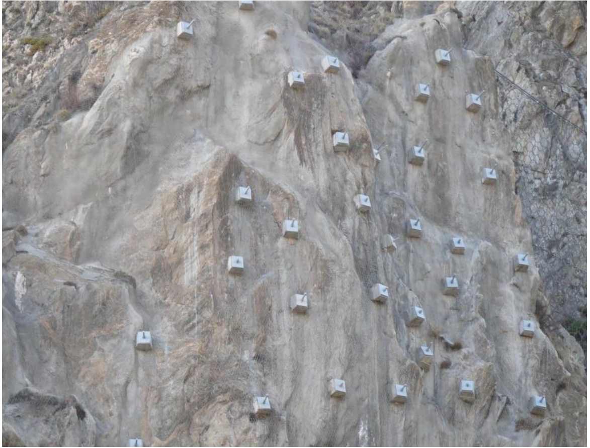
Fotografía 2. Pernos de Anclaje.
