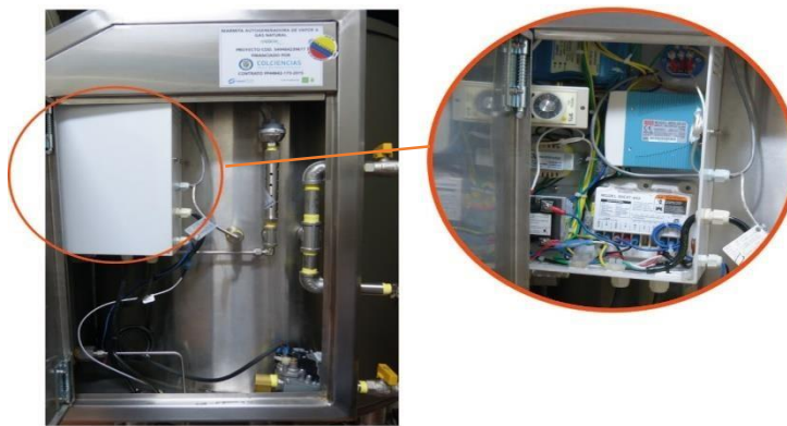
Figura 8. Componentes internos del tablero de control
