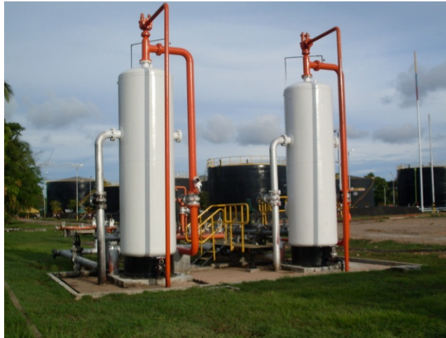
Figura 14. Separador de varios y de prueba.
