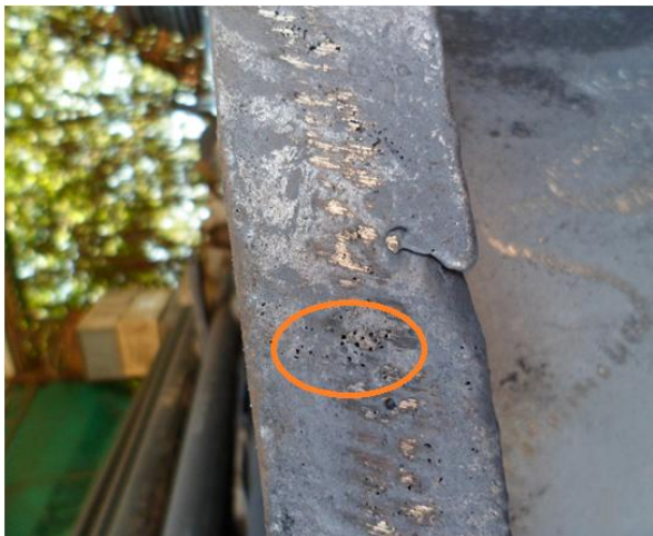
Figura 17. Te para codo de tubería en fundición gris de 20" de diámetro
