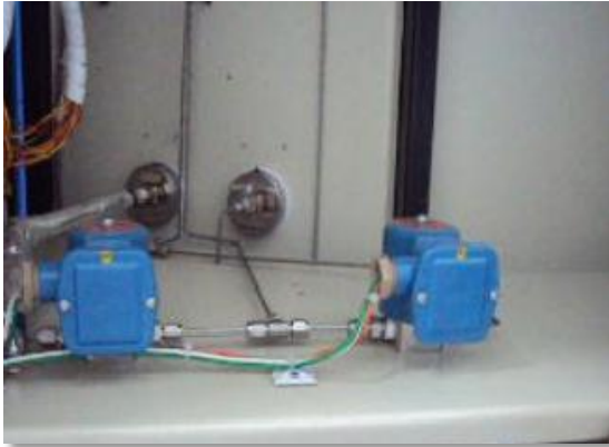
Figura A17. Electroválvulas reguladoras del flujo hacia el transductor de presión.
