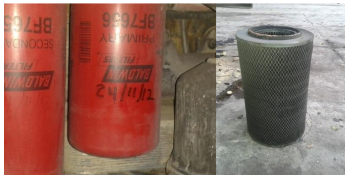
Figura 20. Estado de los filtros de aceite y aire.
