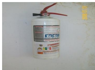
Foto. Extintores portatiles
