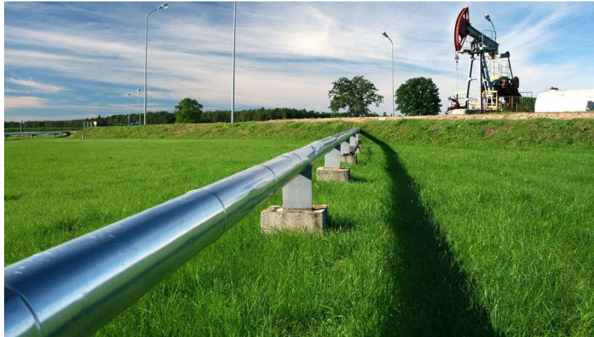
Figura 21. Soportes Estructurales para Oleoductos
