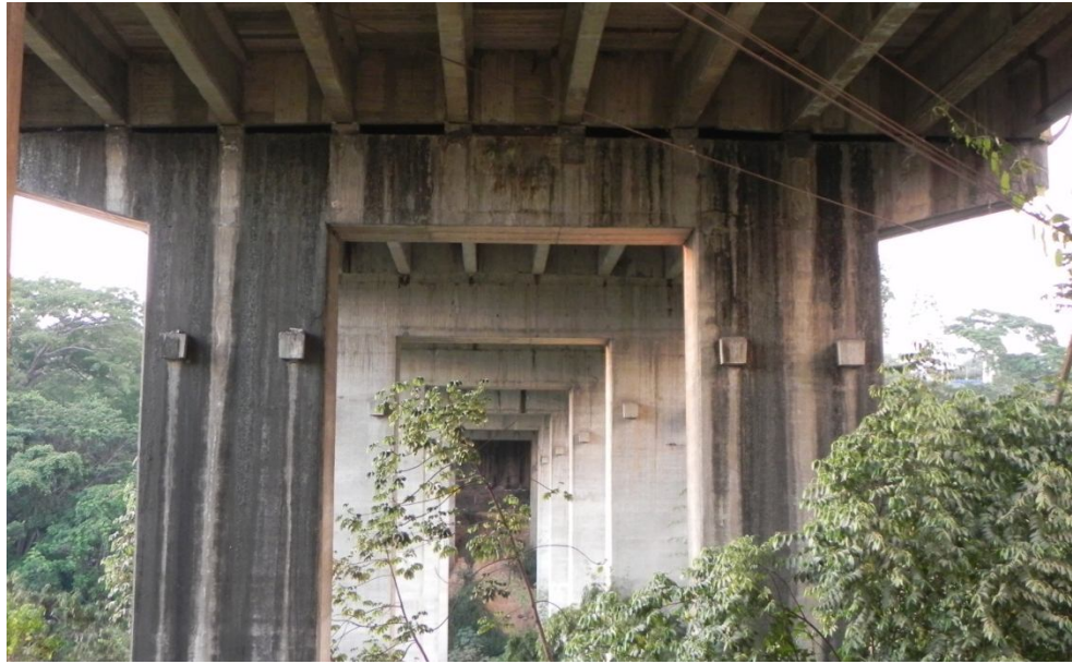
Ilustración 5: Pilas de apoyo.
