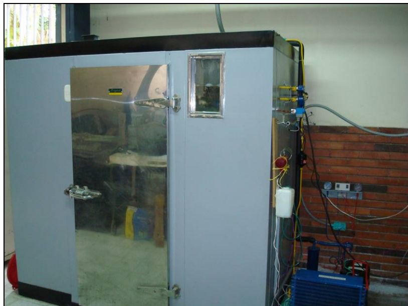
Figura 3. Cámara de enfriamiento.
