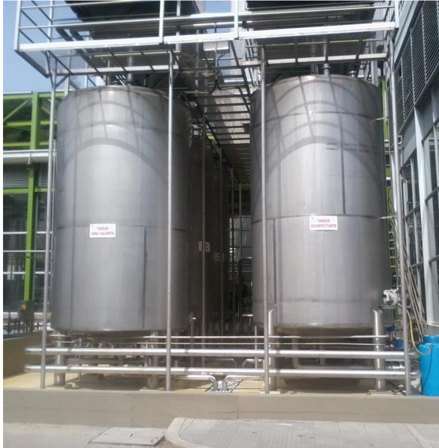
Figura 47. Tanques sistema CIP
