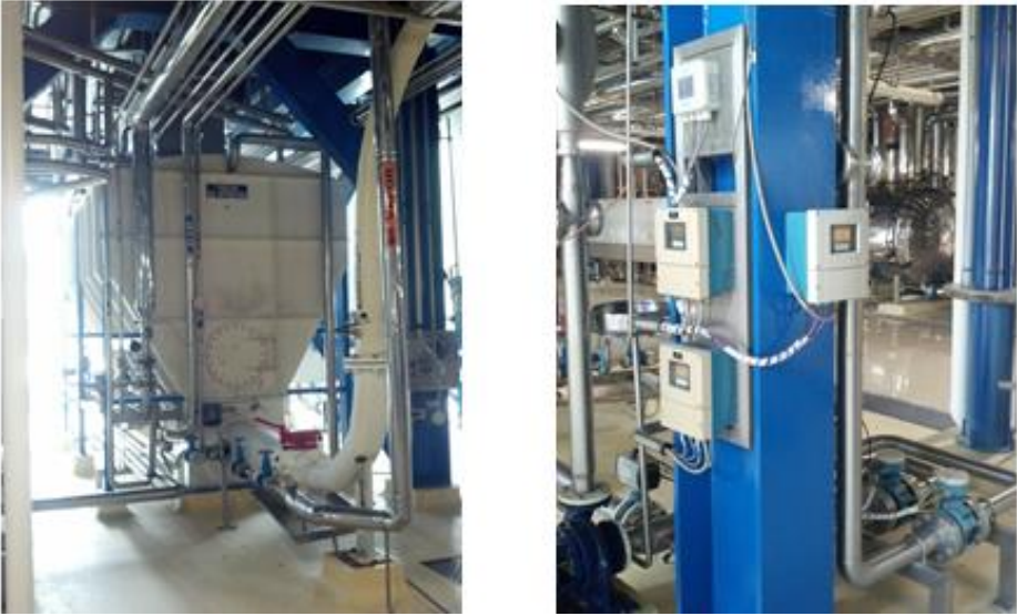
Figura 63. Tolva vista frontal y tablero de control manual, después de la limpieza inicial
