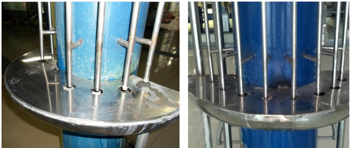
Figura 66. Desagüe válvulas de doble lenteja, antes y después
