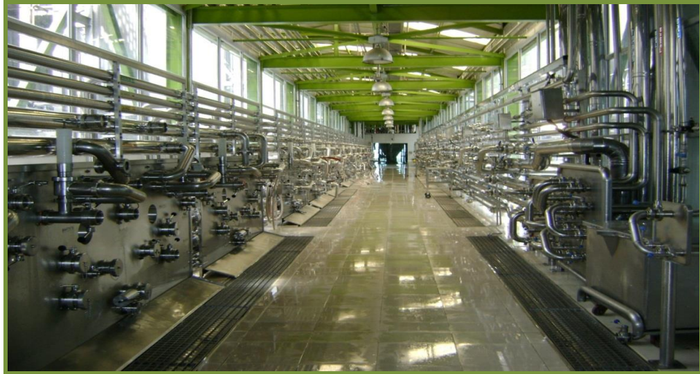
Figura 44. Pasillo de servicios Unitanques
