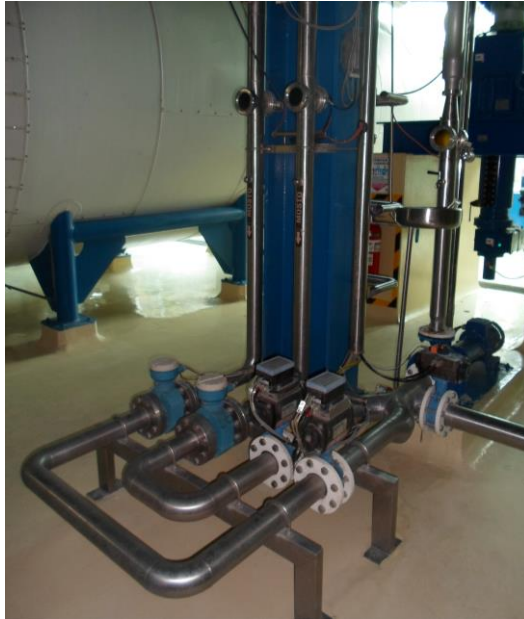
Figura 31. Línea de salida del mosto hacia el tanque auxiliar
