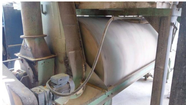
Figura 31. Vista de la enfriadora.
