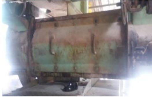
Figura 28. Vista del precocinador.
