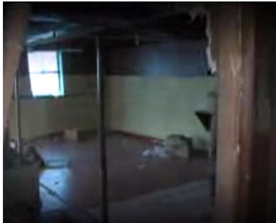
Figura 17. Interior de la casa que explotó en Bainbridge, Ohio.
