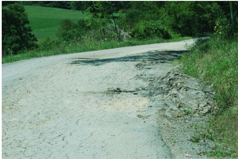
Figura 22. Daño de la carretera en Pennsylvania.
