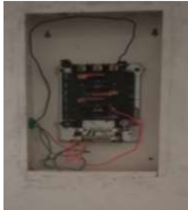
fig. 1: Tablero ubicado en el colegio
