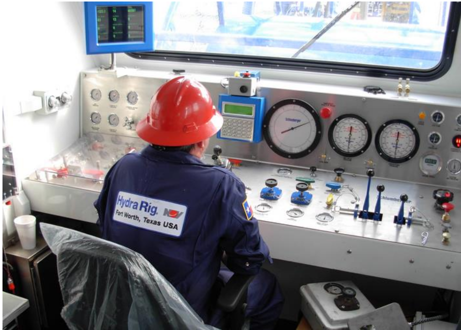
Figura 42. Interior de una Cabina de control
